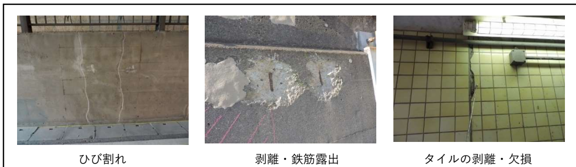
図 2-1. 主な変状状況
