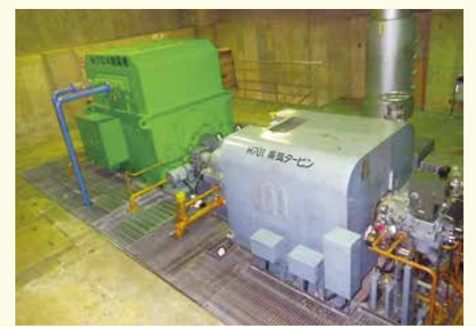
タービン発電機 廃熱ボイラーで蒸気を作り、蒸気タービンを回して電気を作ります。作った電気は、焼却炉の色々な機械の運転や照明に使用しています。
