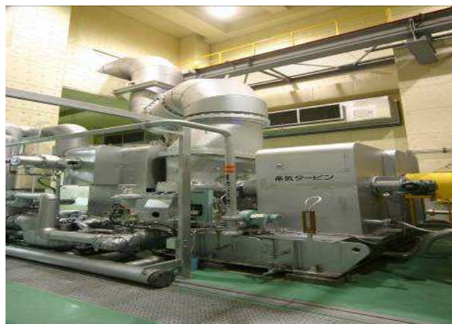
【蒸気タービン & 発電機】
