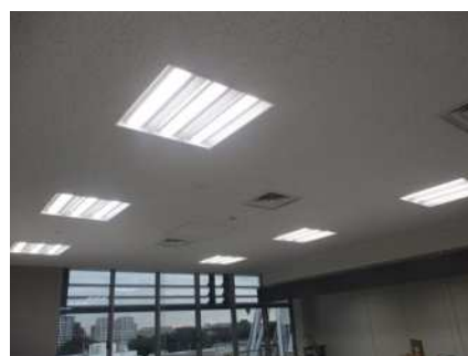
【市役所本庁舎に導入した LED 照明】
