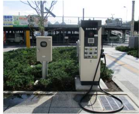
【市役所本庁舎の電気自動車用急速充電器】
