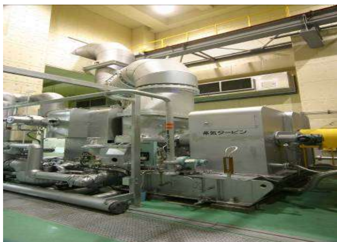
【蒸気タービン&発電機】
